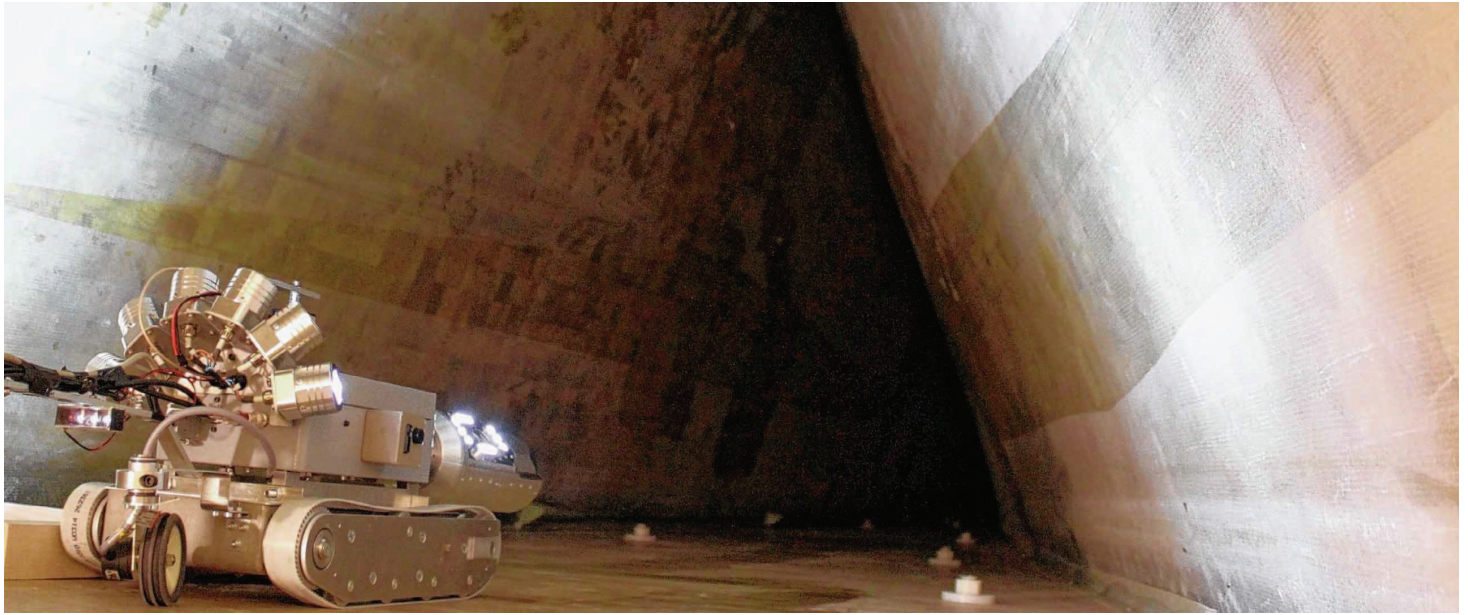
Der Inspektionsroboter im Inneren eines Windrad-Rotorblattes. Hier erkennt der technische Helfer Risse am Material. Über ein Kabel sendet der Roboter sein Kamerabild auf einen Laptop.
